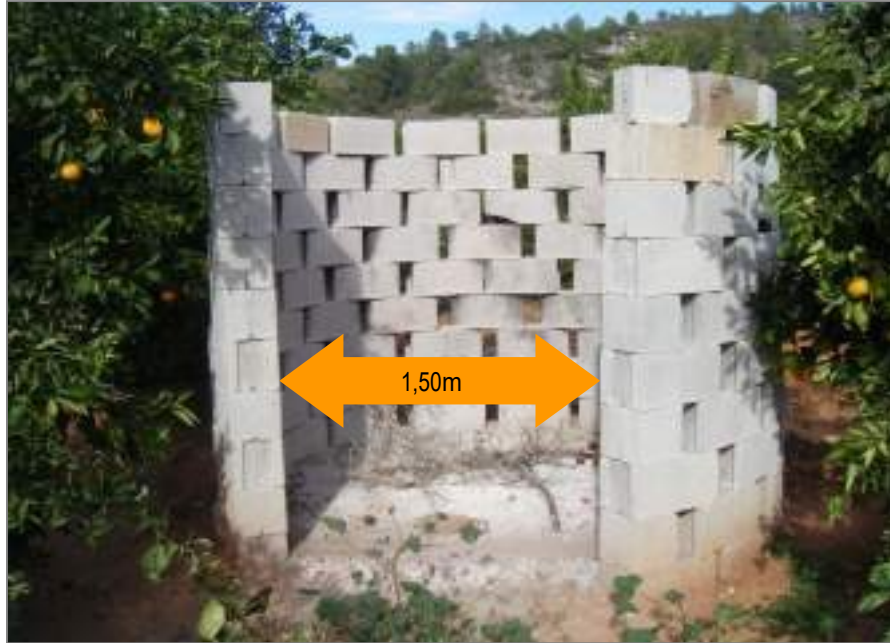
Foto1. Abertura lateral boca de alimentación de un quemador agrícola.
